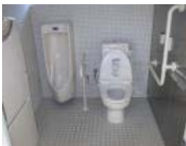
浄化槽での使用
